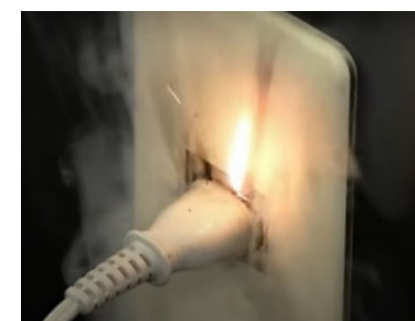
トラッキング火災
