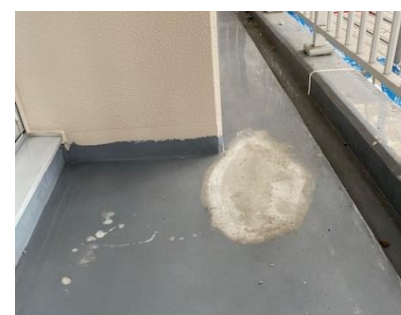
左写真：修繕前
