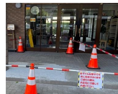
左写真：修繕前
